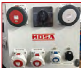
Steckdosenfeld mit Umschalter
