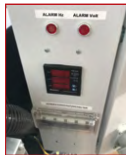
Anzeige V-Hz-A, Hauptsicherung, vom Traktor aus sichtbar
